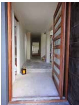
段差をつけた玄関にもタイル貼らないと
